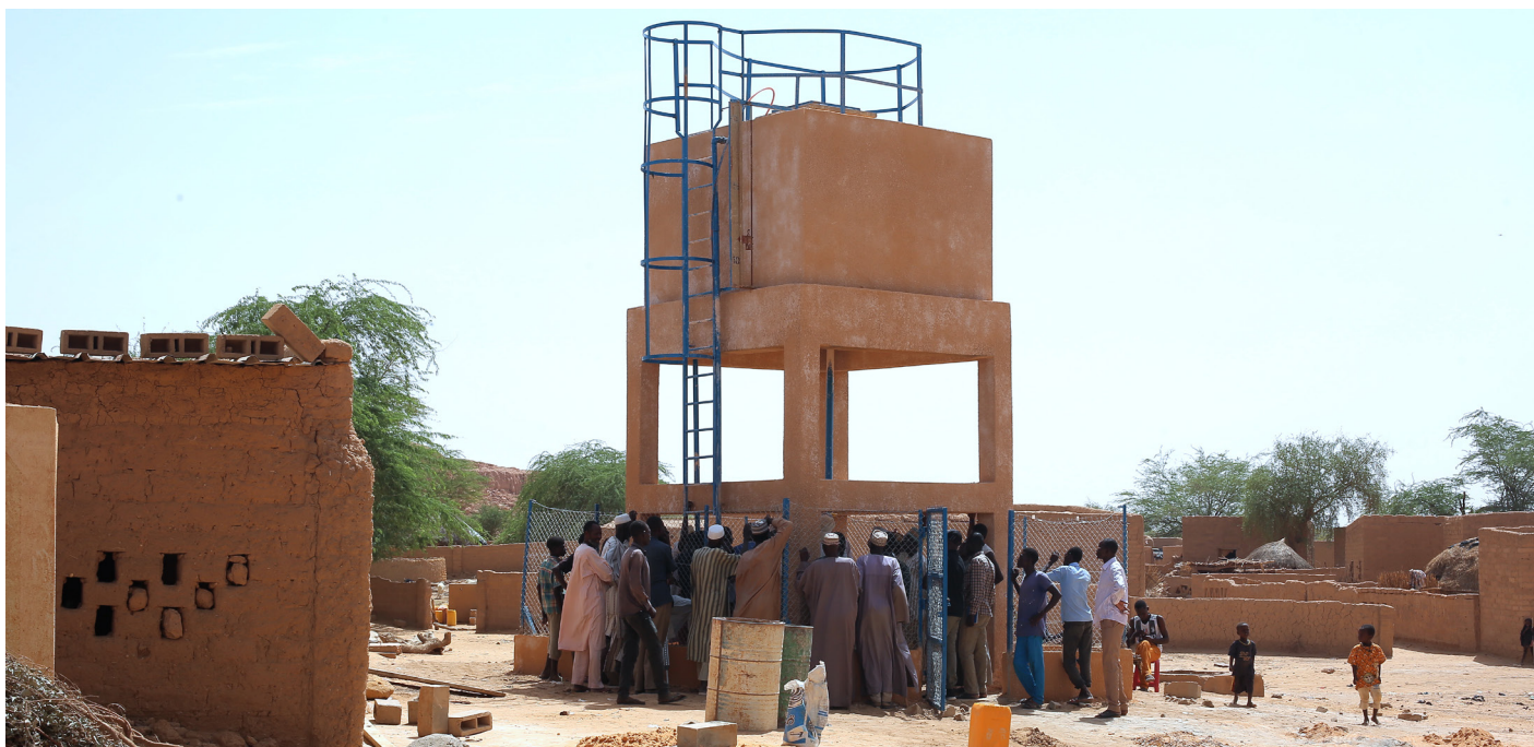
Mini adduction d'eau potable (AEP) réhabilitée dans le village de Toudou/Département de Filingué.
